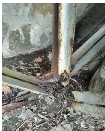
Špatný technický stav lávky přes Bojovský potok
