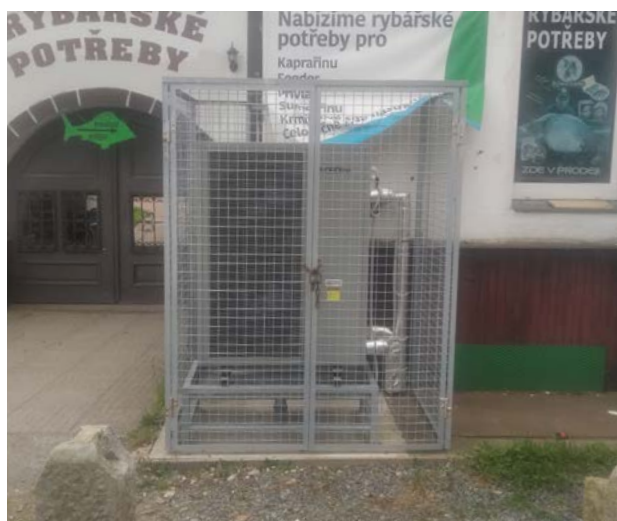
Tepelné čerpadlo u objektu „Penzionu“
