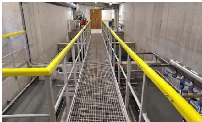
Vnitřní část ČOV
